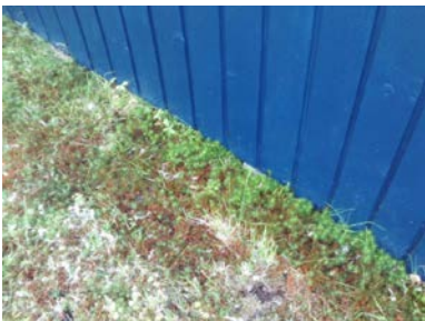
Kledningen ligger nær bakkenivå.
