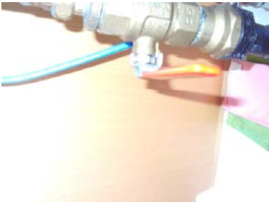
Innvendig stoppekran i kjøkkenbenken.
