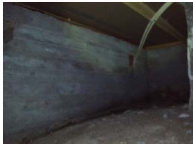
Bra med ventiler i ringmur.
