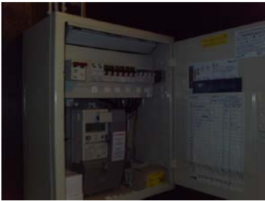
Sikringsskapet er plassert i boden.
