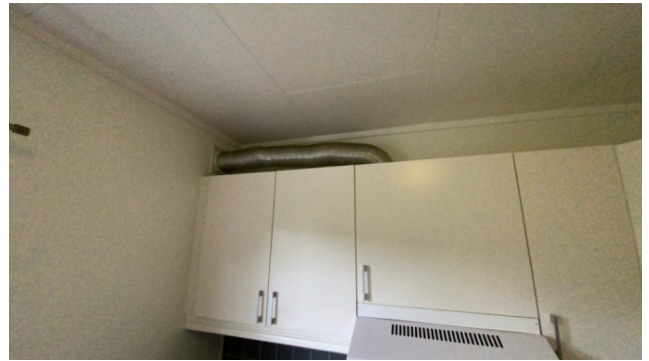
Innkassing av rør bør utføres.
