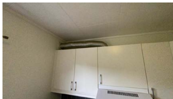
Innkassing av rør bør utføres.
