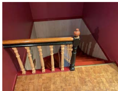
Rekkverk er lavt, 59 cm.
