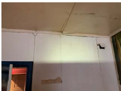
Sprekker og avflassing på overflater, benekket i 2.etasje
