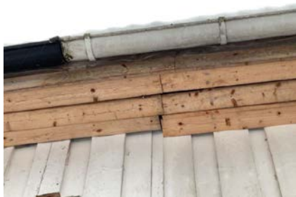
Bemerket ufagmessig utførelse på tilbygg
