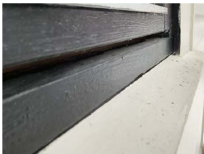
Manglende vannbrettvrslag og bord avsluttet ved vindu
