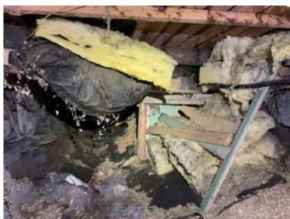
Fuktig miljø der isolasjon ligger åpent
