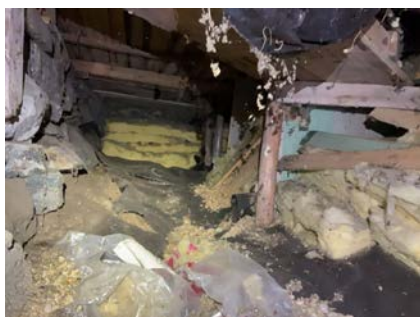
Enkel oppstøtning med stolper av tre ned på terreng og utsatt for bevegelse i grunn
