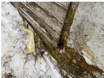
Råte i kjellerluke, tiltak med utskifting anbefales
