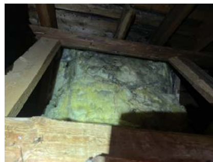
Pipe i kryploft belagt med mineralull, ikke egnet
