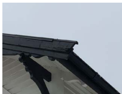
Slitasje på vindskie
