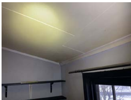
Merker/slitasje på overflater, merkbar lukt i bolig nærliggende røyklukt
