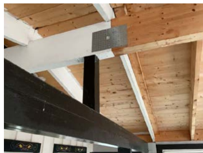
Skjøt på limtre er ikke egnet da det mangler underliggende bæring.
