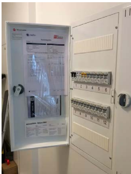
Sikringsskap i teknisk rom.
