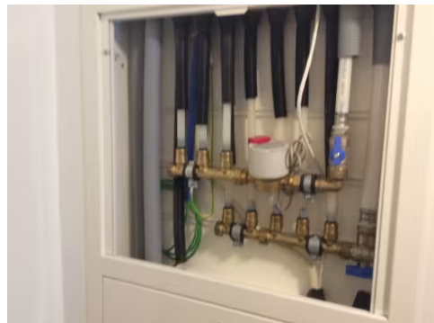
Vannfordelerskap i teknisk rom.
