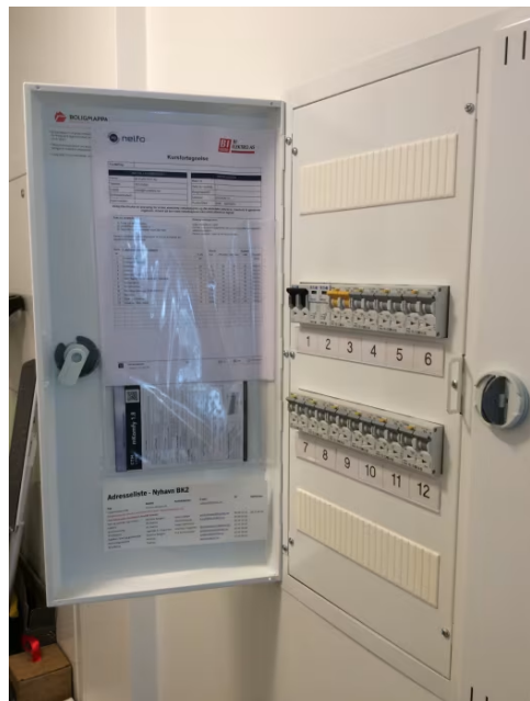
Sikringsskap i teknisk rom.
