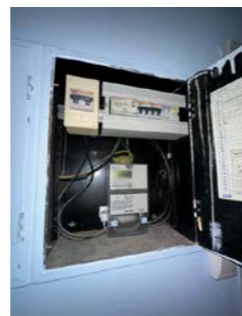
Sikringsskap plassert i felles oppgang.
