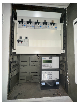
Sikringsskap med automatsikringer.
