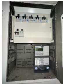
Sikringskap med automatsikringer.
