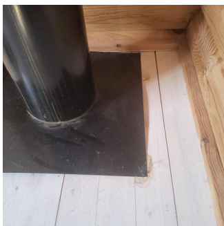
Skorsteiner inne i boligen - Fuktsjolder på pipen og på gulvflaten rundt pipen
