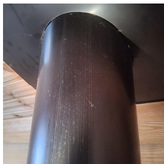
Skorsteiner inne i boligen - Fuktsjolder på pipen
