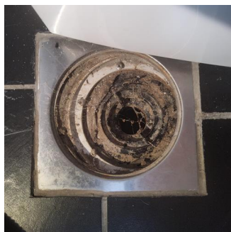
Avløp (inkl. sluk) - Sluk - Vaskerom
