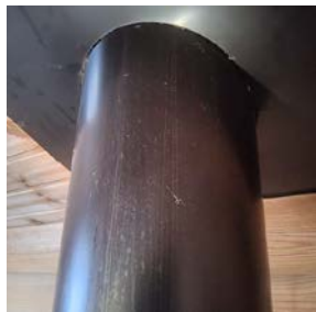
Skorsteiner inne i boligen - Fuktsjolder på pipen
