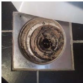
Avløp (inkl. sluk) - Sluk - Vaskerom
