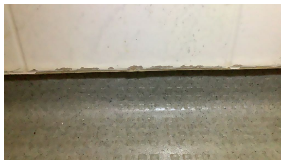
Eksempler på svelling i nedkant av baderomsplater.
