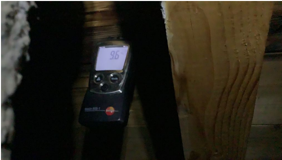
Råteskadet taktro nedenfor pipe måles tørr.
