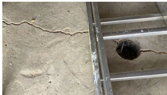
Sprekkdannelse i støpt plate.
