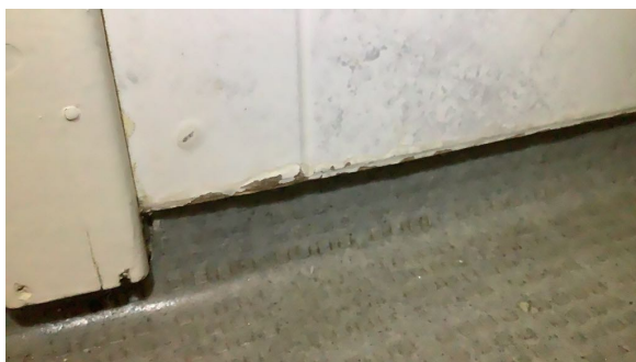
Eksempler på svelling i nedkant av baderomsplater.
