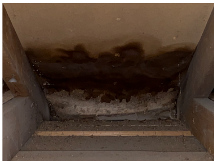
Fuktskadet taktro av spon.
