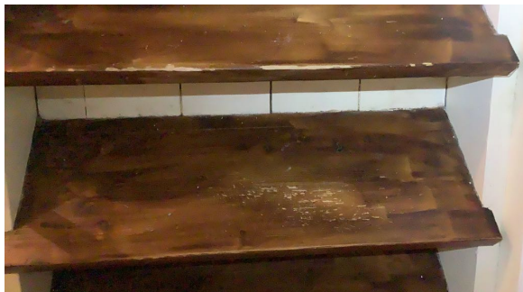
Eksempel på slitasje i trinn.
