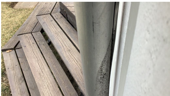
Eksempel på frostsprengt nedløpsrør.
