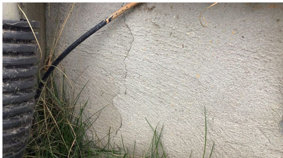
Utvendig skråriss i grunnmur.
