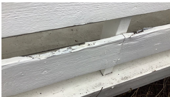
Eksempel på råteskadet rekkverksbord.
