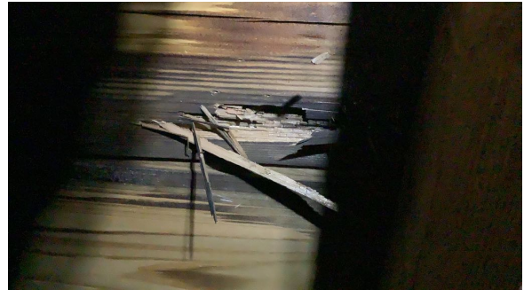
Råteskadet taktro nedenfor pipe.
