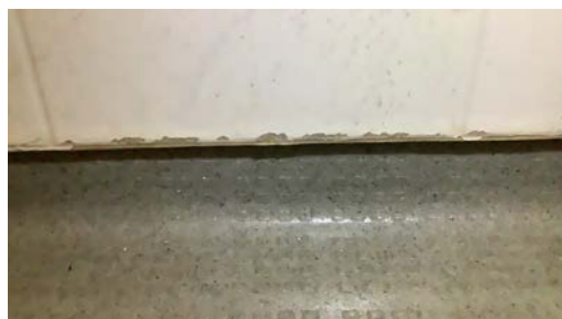
Eksempler på svelling i nedkant av baderomsplater.
