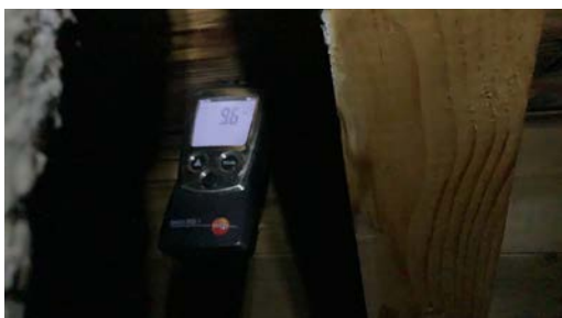
Råteskadet taktro nedenfor pipe måles tørr.
