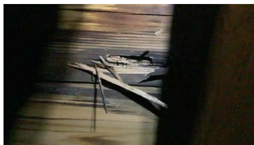
Råteskadet taktro nedenfor pipe.
