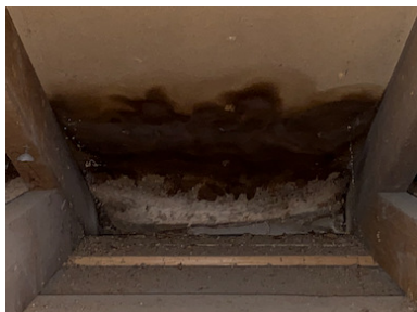
Fuktskadet taktro av spon.
