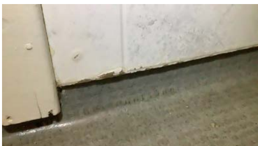
Eksempler på svelling i nedkant av baderomsplater.
