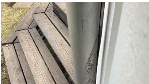
Eksempel på frostsprengt nedløpsrør.
