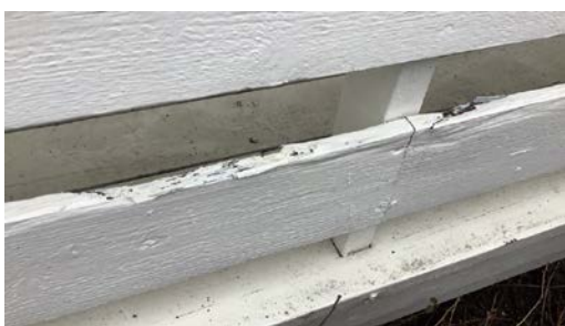
Eksempel på råteskadet rekkverksbord.
