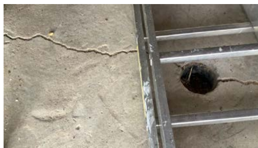
Sprekkdannelse i støpt plate.
