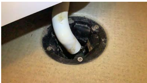
Plastsluk, og vinylbelegg er ført under slukets klemring.
