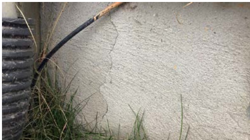
Utvendig skråriss i grunnmur.
