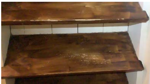
Eksempel på slitasje i trinn.
