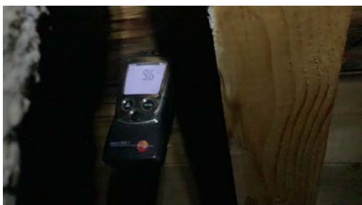
Råteskadet taktro nedenfor pipe måles tørr.
