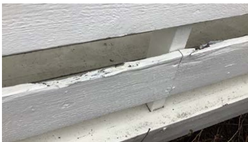
Eksempel på råteskadet rekkverksbord.
