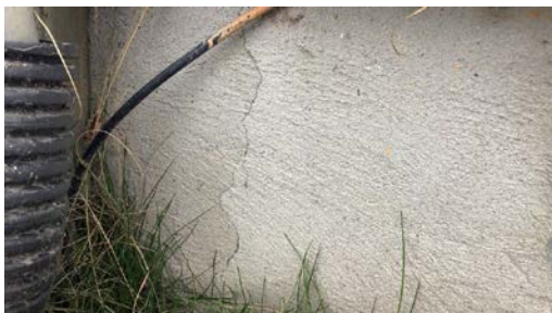
Utvendig skråriss i grunnmur.
