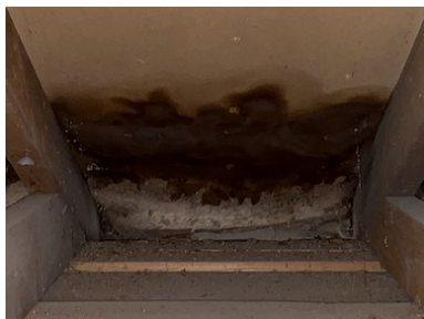
Fuktskadet taktro av spon.
