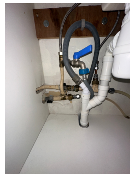
Rørøpplagg under servant på bad
