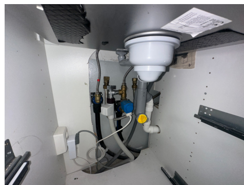
Rørøpplagg i kjøkkenbenk med Waterguard
