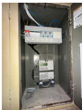
Sikringsskap med automatsikringer.
