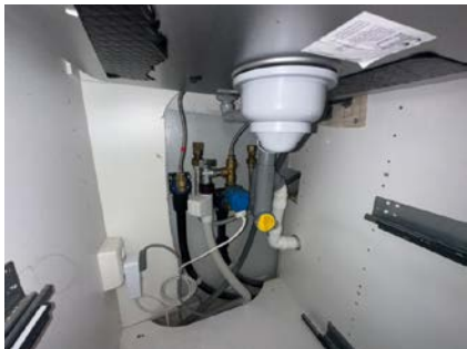
Røropplegg i kjøkkenbenk med Waterguard
