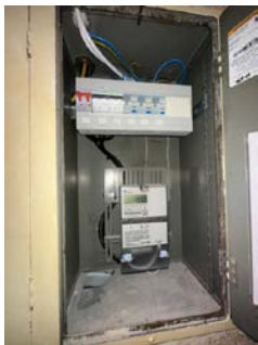
Sikringsskap med automatsikringer.
