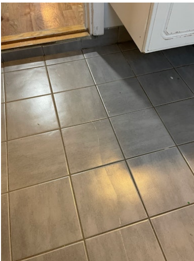
Sprekk i gulvfliser
