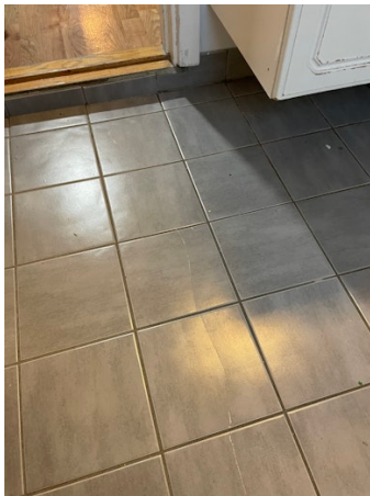
Sprekk i gulvfliser
