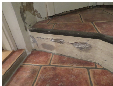
Avflassing fra fukt-opsug fra grunnen.
