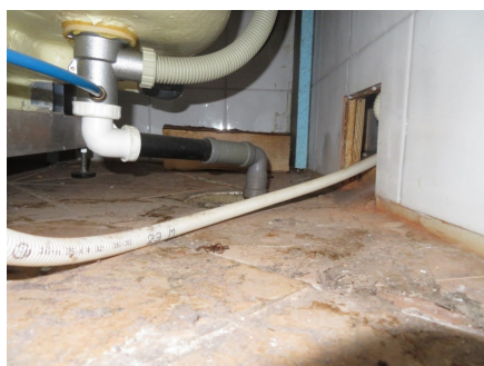
Åpning i vegg under badekar. Sluk ikke tilgjengelig.
