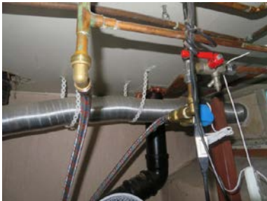
Avtrekkskanal fra bad ført til yttervegg.
