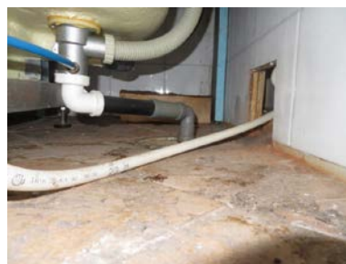
Åpning i vegg under badekar. Sluk ikke tilgjengelig.
