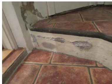
Avflassing fra fukt-oppsug fra grunnen.
