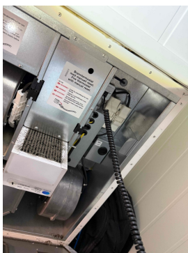
Bildet viser filterkassett i ventilasjonsanlegget.
