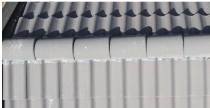
Bildet viser mønepanner uten antydning til innfesting.
