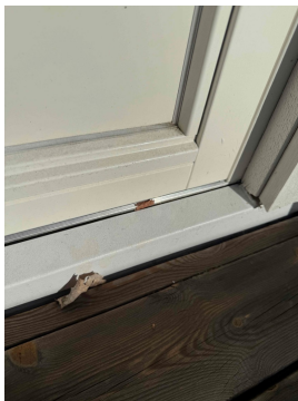
Bildet viser utetthet mellom beslag og terskel ved verandadør i 2. etasje.
