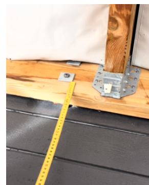
Bildet viser innfestingsskruer i veranda som ikke er tilstrekkelig skrudd til.
