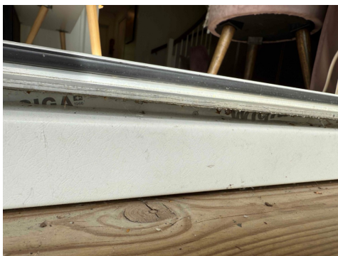
Bildet viser løst terskelbeslag på terrassedør i 1 etasje..
