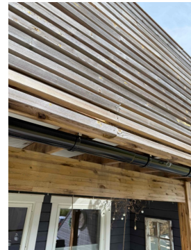
Bildet viser løs rekkverkspile og ujevnheter i spile.
