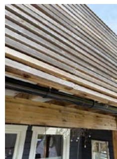
Bildet viser løs rekkverkspile og ujevnheter i spile.
