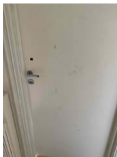
Bildet viser skade på dørrblad til soverom i 2 etasje.
