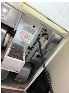
Bildet viser filterkassett i ventilasjonsanlegget.
