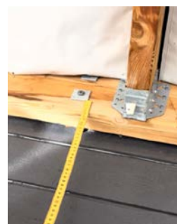
Bildet viser innfestingskruser i veranda som ikke er tilstrekkelig skrudd til.
