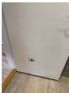
Bildet viser skade på dørrblad til badet i 2 etasje.
