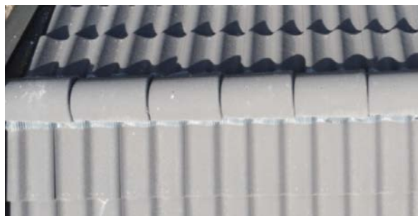
Bildet viser mønepanner uten antydning til innfesting.
