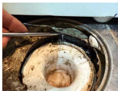
Bildet viser sluket i boden.
