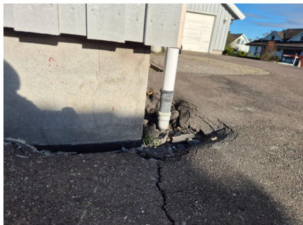
Grop mot grunnmur.
