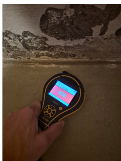
Indikert fukt i gulv og synlig saltutslag på vegg.
