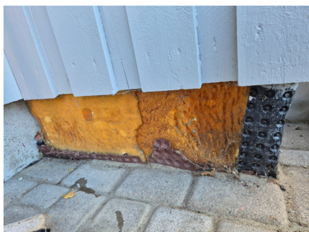
Grunnmursplast mangler i hjørnet.
