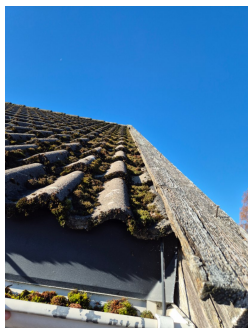
Moselagt takstein og råte i israftbord.
