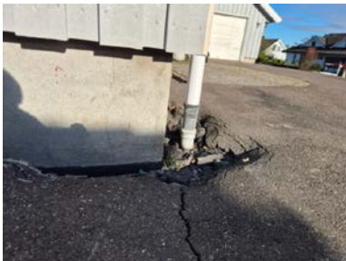
Grop mot grunnmur.
