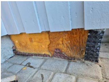
Grunnmursplast mangler i hjørnet.
