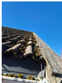
Moselagt takstein og råte i israftbord.
