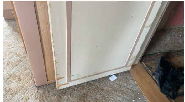
Skader på dører
