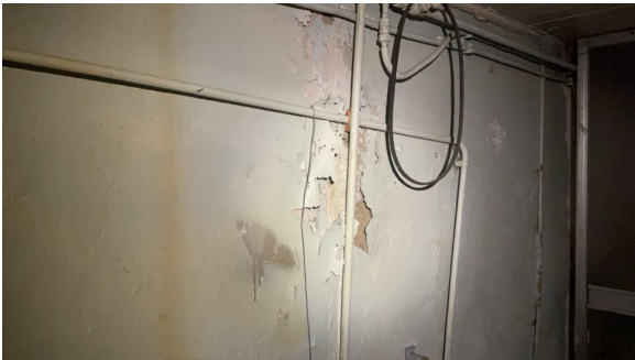
Saltutslag og flassing på vegger.
