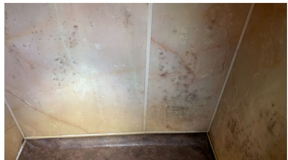
Muggskader på overflater.
