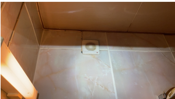
Avtrekksvifte er defekt.
