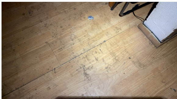
Skader på laminat.
