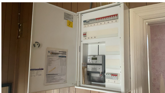
Sikringsskap plassert i 2. etasje.
