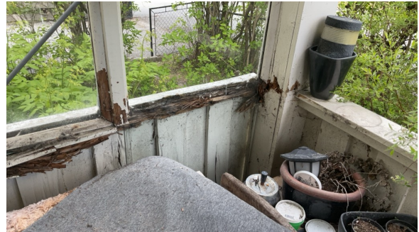
Råteskader i konstruksjon.
