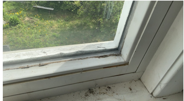
Kondensmerker/fuktmerker på enkelte vinduer.
