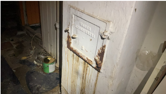
Sotluke pipe 1 plassert i kjeller.
