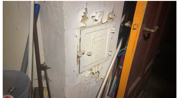
Sotluke pipe 2 plassert i kjeller.
