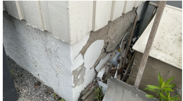
Forvittring av mur registrert.
