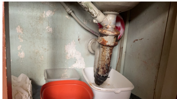
Rustskader på avløpsrør.
