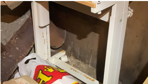
Fukt og råteskade på "påforede" vegger.
