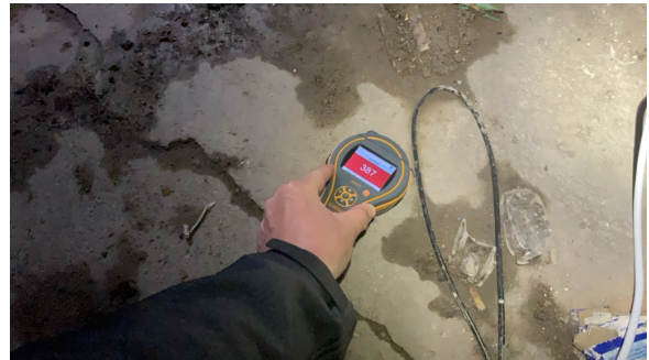
Med enkle fuktsøk på gulv ble det registrert fukt.
