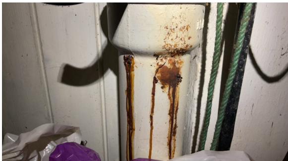
Rustskader på avløpsrør
