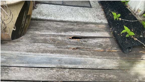
Råteskader i gulv.
