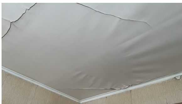
Skader på himling 2. etasje.
