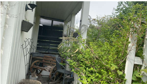
Skjevheter i søyler som er bærende konstruksjon
