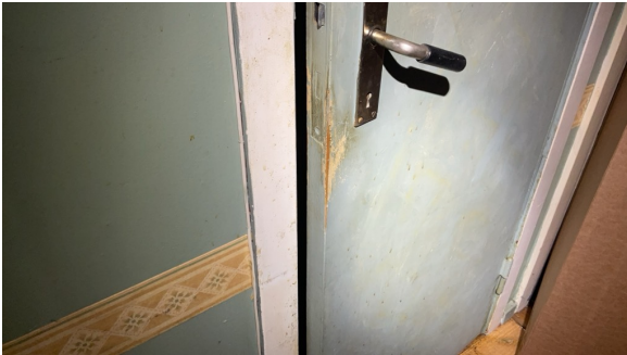
Slitasje på dører.
