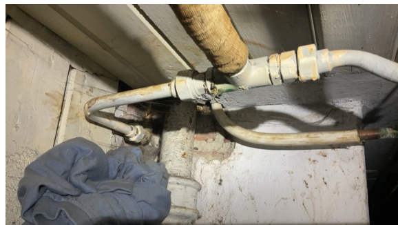
Lekkasje fra kobling.
