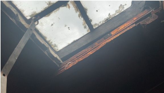
Loftsvindu i dårlig stand.
