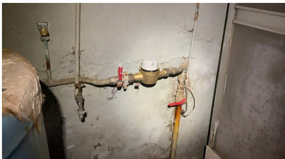
Stoppekran plassert i kjeller.
