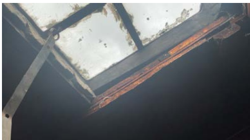
Loftsvindu i dårlig stand.
