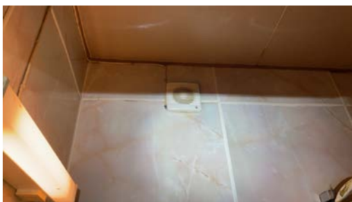
Avtrekksvifte er defekt.
