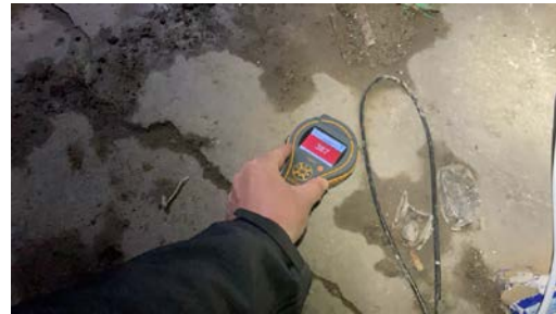
Med enkle fuktsøk på gulv ble det registrert fukt.
