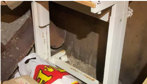
Fukt og råteskade på "påforede" vegger.
