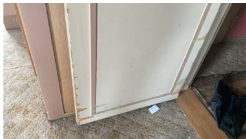
Skader på dører
