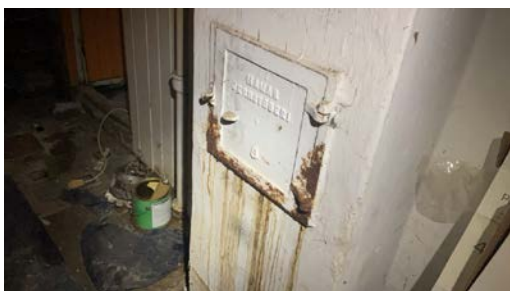
Sotluke pipe 1 plassert i kjeller.
