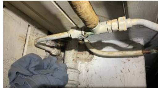
Lekkasje fra kobling.
