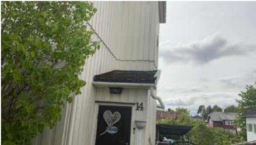
Mose på taktekking av er inngangsparti.
