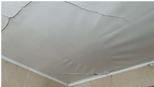
Skader på himling 2. etasje.
