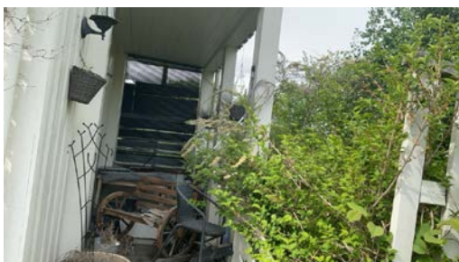
Skjevheter i søyler som er bærende konstruksjon
