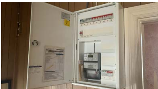
Sikringsskap plassert i 2. etasje.
