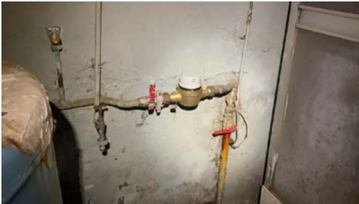
Stoppekran plassert i kjeller.
