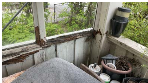
Råteskader i konstruksjon.
