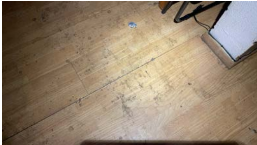
Skader på laminat.
