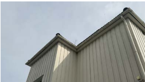
Gress vokser i takrenner og disse må rengjøres.
