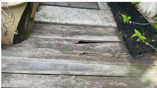
Råteskader i gulv.
