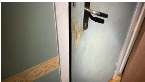
Slitasje på dører.
