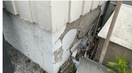
Forvittring av mur registrert.
