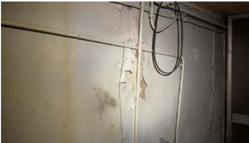
Saltutslag og flassing på vegger.
