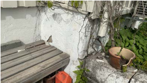
Løs murpuss flere steder.
