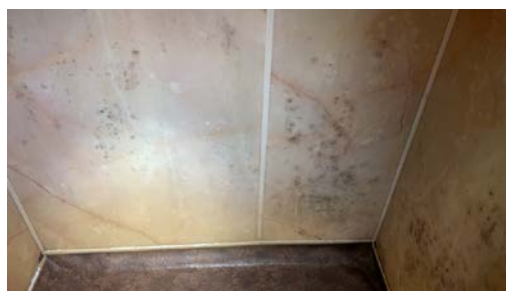
Muggskader på overflater.
