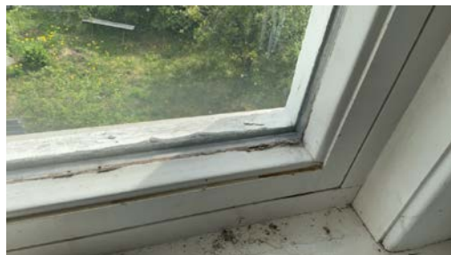
Kondensmerker/fuktmerker på enkelte vinduer.
