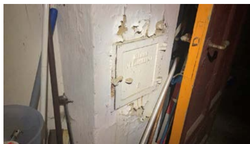
Sotluke pipe 2 plassert i kjeller.
