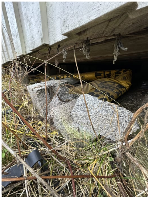
Viser defekt fundament under stuedel.
