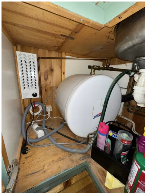
Bereder plassert i kjøkkenskap. Ukjent vedrørende understøtte, fast sokkel.
