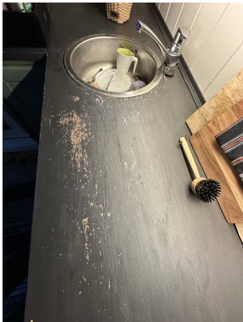
Benkeplate med behov for overflatebehandling.
