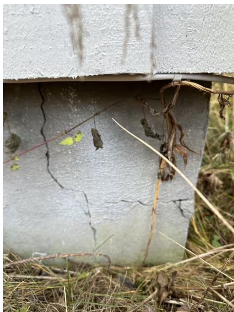
Grunnmuren har skader/sprekker.
