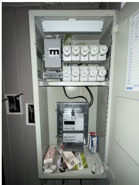
Viser vegghengt sikringskapp plassert i vindfang.
