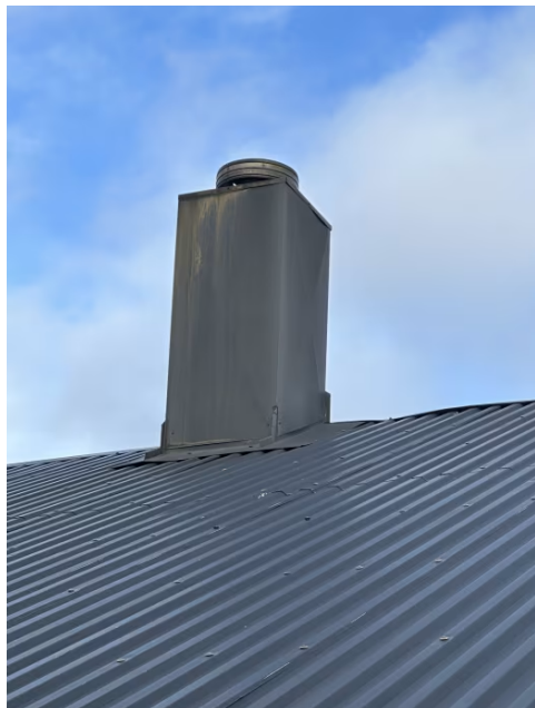
Viser helseslått pipe over tak. Anbefaler ytterligere undersøkelser.
