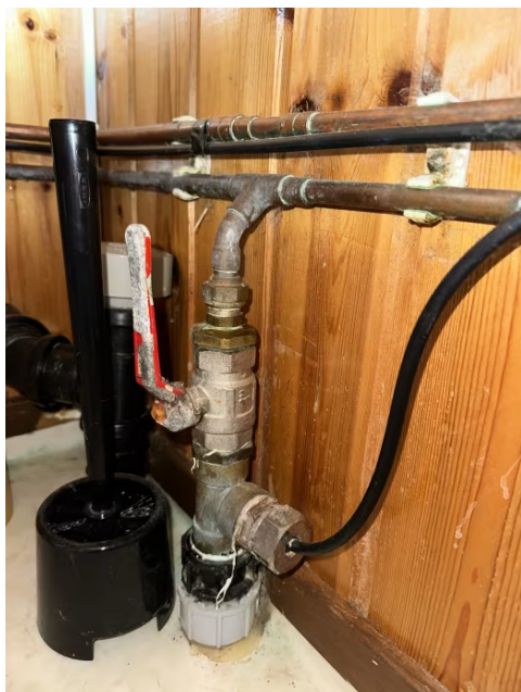
Vanninntak og hovedstoppekran plassert på bad. Etablert varmekabler på rør. Det registreres drypplekkasje på kobling.
