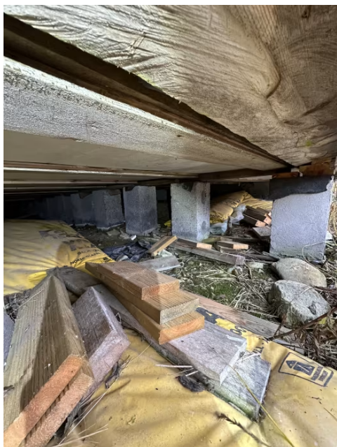
Det registreres skjevheter i søyler/ fundamenter.
