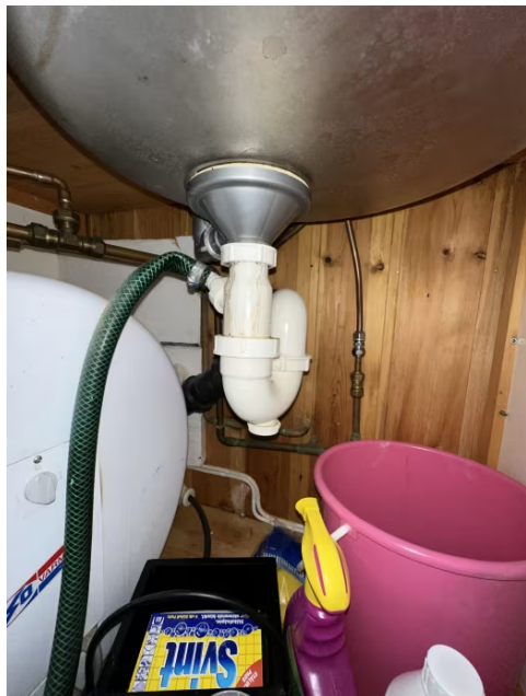
Viser vann og avløpsinnstallasjoner under kum.
