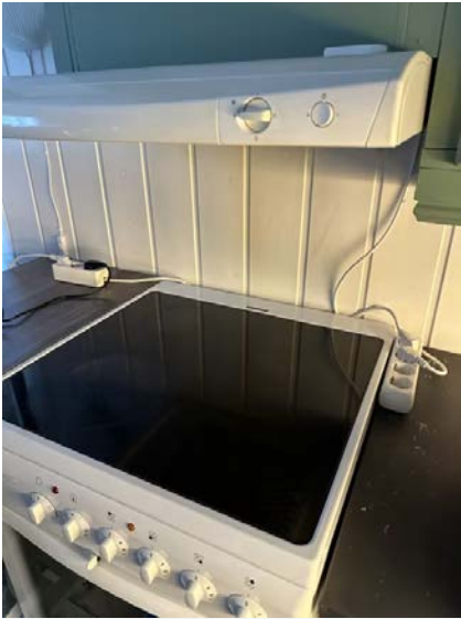
Det registreres omfattende bruk av skjøteledninger ved kjøkkenet.
