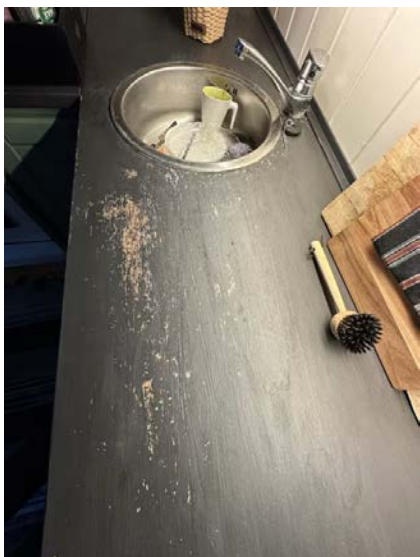
Benkeplate med behov for overflatebehandling.
