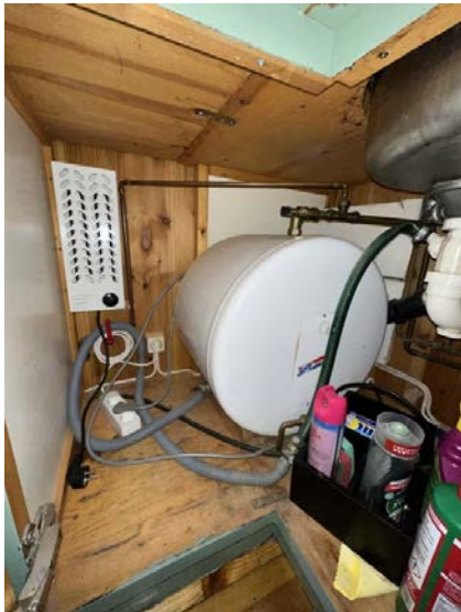
Bereider plassert i kjøkkenskap. Ukjent vedrørende understøtte, fast sokkel.
