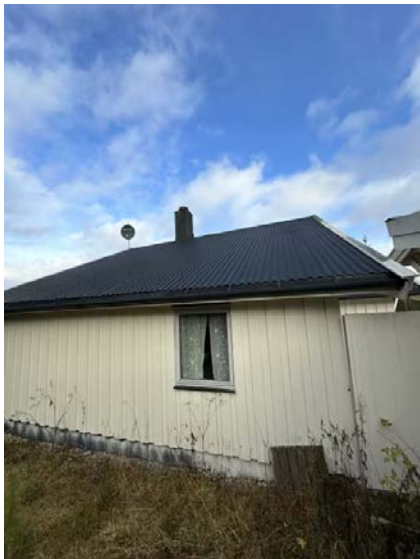
Viser saltak tekket med metallplater. Beslag på isbord anbefales etablert.
