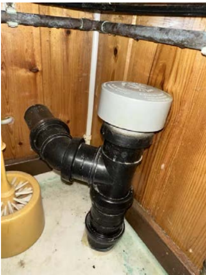
Kloakk er ikke luftet over tak. Lufting med vakumventil på bad.
