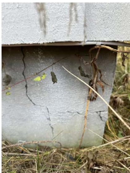
Grunnmuren har skader/sprekker.
