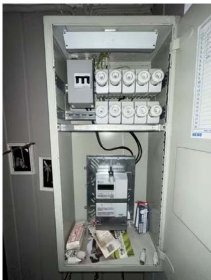
Viser vegghengt sikringsskap plassert i vindfang.
