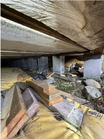
Det registreres skjevheter i søyler/ fundamenter.
