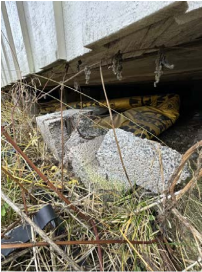
Viser defekt fundament under stuedel.
