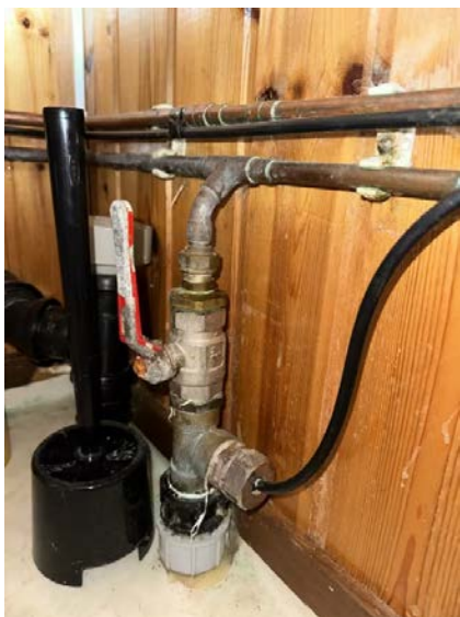
Vanninntak og hovedstoppekran plassert på bad. Etablert varmekabler på rør. Det registreres drypplekkasje på kobling.
