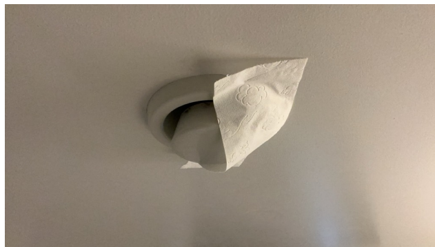
Bilde viser funksjonstest av avtrekk
