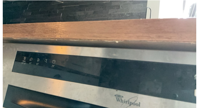
Slitasje av fukt på benkeplate.
