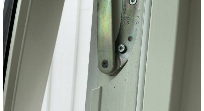
Kjøkkenvindu. Skade på hengsle.
