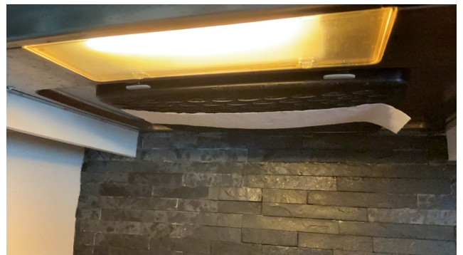
Bilde viser funksjonstest av avtrekk
