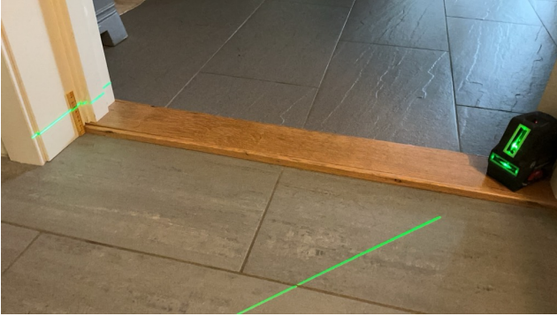
Måler 56mm på gulv ved terskel.
