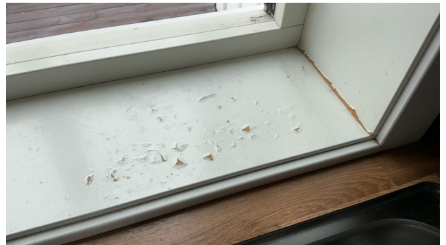
Kjøkkenvindu. Svellet foring fra vannsprut.
