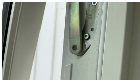
Kjøkkenvindu. Skade på hengsle.
