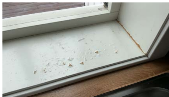
Kjøkkenvindu. Svellet foring fra vannsprut.
