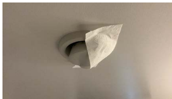
Bilde viser funksjonstest av avtrekk
