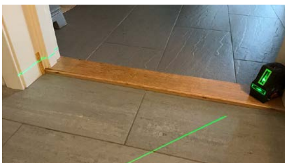
Måler 56mm på gulv ved terskel.
