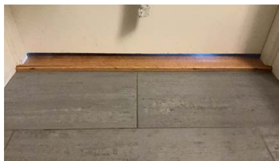
Spalte under dør for tilluft.
