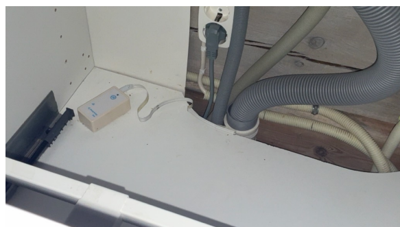
Lekkasjevakt på kjøkken.
