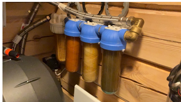
Flere vannfilter på teknisk rom.
