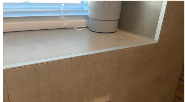
Noe avskaling på kanter av skjørte fliser.
