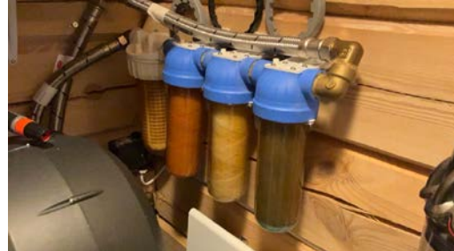
Fleire vannfilter på teknisk rom.
