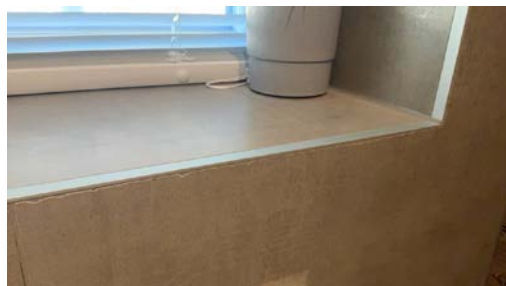
Noe avskaling på kanter av skjørte fliser.
