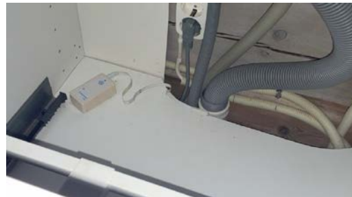
Lekkasjevakt på kjøkken.
