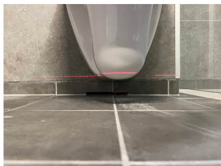
Spalte mot gulv under toalett.
