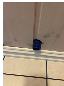
Avrenningsrør uten siklemikk.
