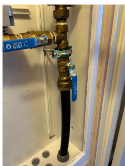
Boden: Rørskap med vanninntak/stoppekran.
