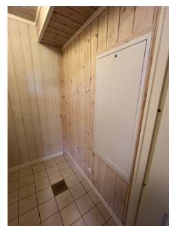
Boden: Rørskap med vanninntak/stoppekran.
