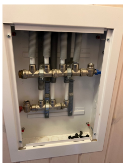
Rørskap i boden - ikke merket kurser.
