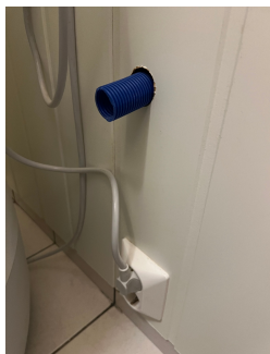
El-kontakt for varmtvannsbereder under avrenningsrør fra rørskap.
