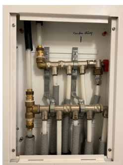
Rørskap i teknisk rom- ikke merket kurser.
