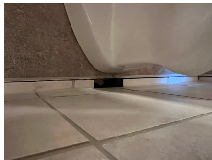
Synlig spalte mot gulv.
