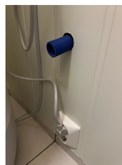
Avrenningsrør fra rørskap over el-kontakt. Uten siklemikk.
