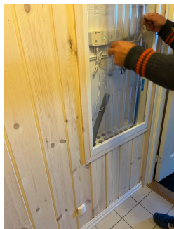
Boden: Rørskap med vanninntak/stoppekran.
