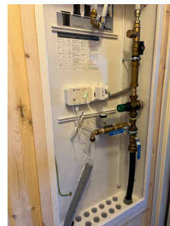
Boden: Rørskap med vanninntak/stoppekran.
