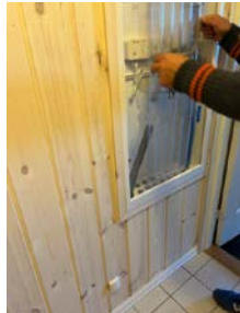
Boden: Rørskap med vanninntak/stoppekran.
