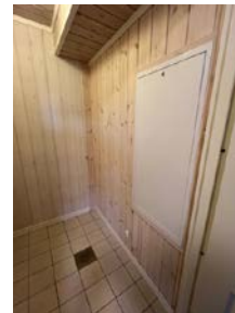
Boden: Rørskap med vanninntak/stoppekran.
