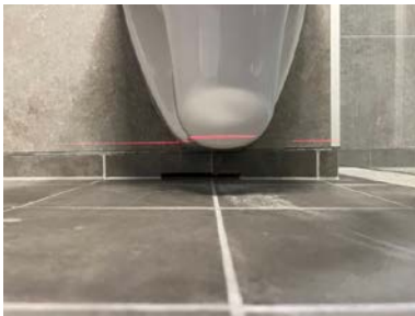
Spalte mot gulv under toalett.
