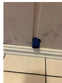
Avrenningsrør uten siklemikk.
