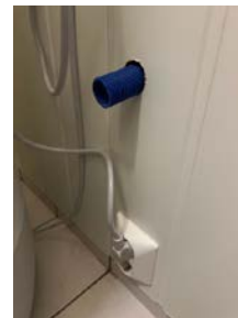
Avrenningsrør fra rørskap over el-kontakt. Uten siklemikk.
