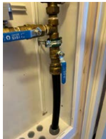
Boden: Rørskap med vanninntak/stoppekran.
