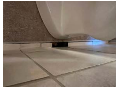
Synlig spalte mot gulv.
