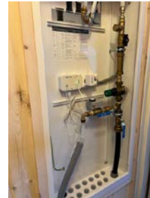
Boden: Rørskap med vanninntak/stoppekran.
