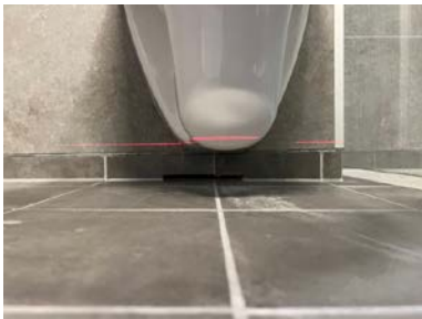
Spalte mot gulv under toalett.
