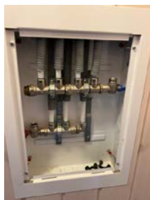
Rørskap i boden - ikke merket kurser.
