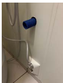
El-kontakt for varmtvannsbereder under avrenningsrør fra rørskap.
