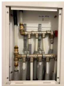
Rørskap i teknisk rom - ikke merket kurser.
