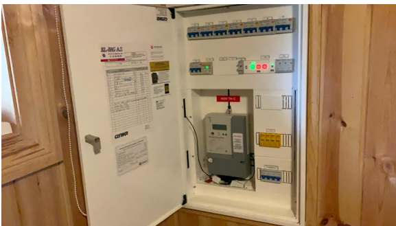
Sikringsskap med automatsikringer er plassert i gang.
