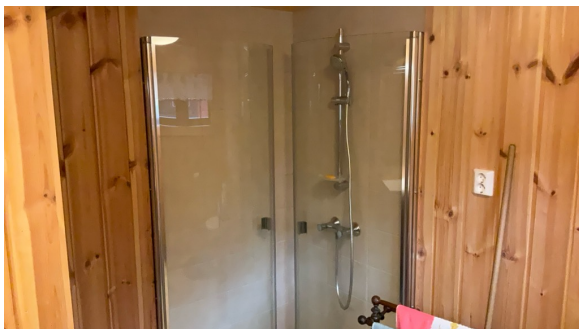
Ikke fuktsikker overflate i våtsonen. Figur viser våtsoner på våtrom. Hentet fra SINTEF Byggeforsk.
