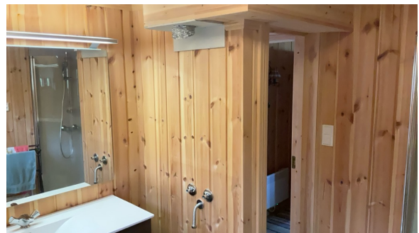
Opplegg for varmtvannsbereder på gass. Opplyst at denne ble fjernet etter det ble innlagt strøm.
