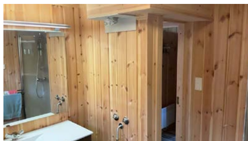
Opplegg for varmtvannsbereider på gass. Opplyst at denne ble fjernet etter det ble innlagt strøm.
