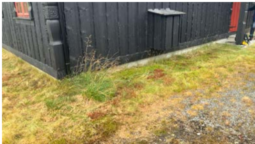
Stedvis fall på terreng mot bygning.
