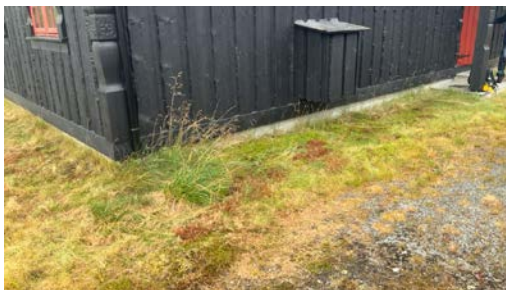
Stedvis fall på terreng mot bygning.
