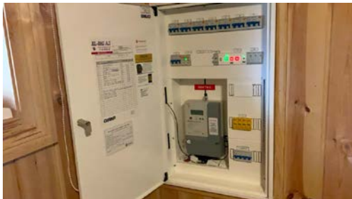
Sikringsskap med automatsikringer er plassert i gang.
