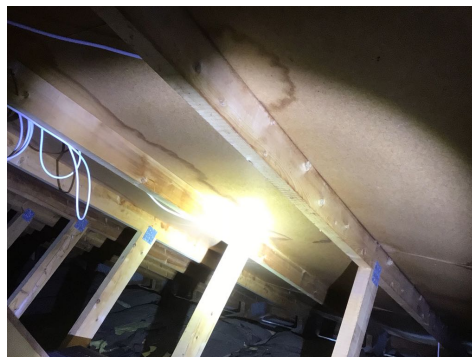
Eldre fuktmerker i undertak
