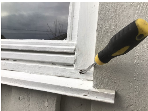
Fukt i vinduskarm
