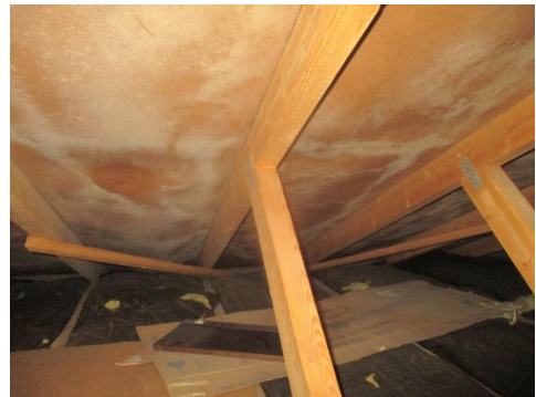
En del kondensmerker på undertaket.
