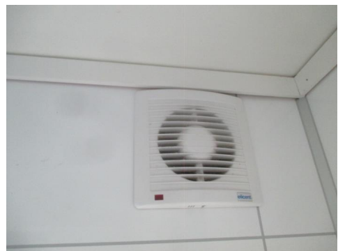
Vifte i ytterveggen.
