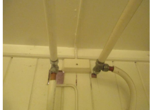
Noe eldre kobberør.
