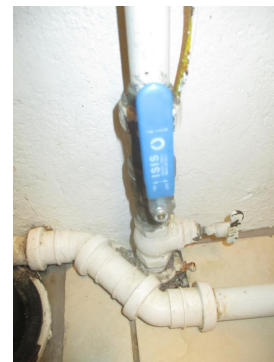
Innvendig stoppekran på vaskerommet.
