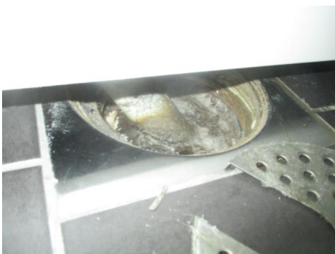
Sluk under dusjkabinett.
