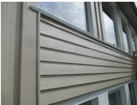
En del kledning er blitt byttet i samband med skifting av vinduer.
