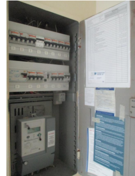
Sikringsskapet er plassert i trapperom til underetasjen.
