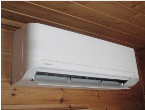
Ny varmepumpe i fra 2021.
