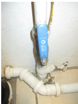
Innvendig stoppekran på vaskerommet.
