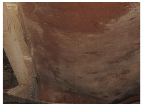
Merker på undertaket.
