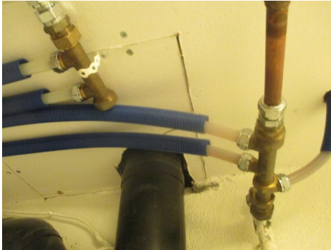
Rør i rør til bad i hovedetasjen uten fordelserskap.
