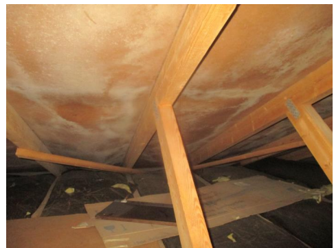
En del kondensmerker på undertaket.
