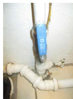
Innvendig stoppekran på vaskerommet.
