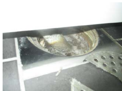
Sluk under dusjkabinett.
