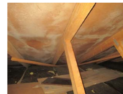
En del kondensmerker på undertaket.
