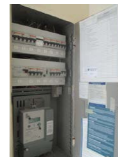
Sikringsskapet er plassert i trapperom til underetasjen.
