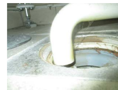
Sluk under dusjkabinett.
