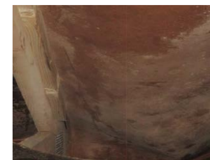
Merker på undertaket.
