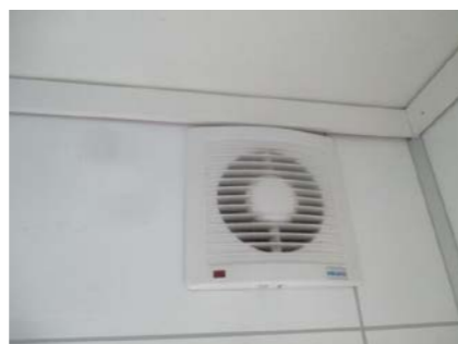
Vifte i ytterveggen.
