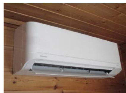
Ny varmepumpe i fra 2021.
