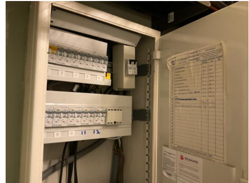
Sikringsskap i entreen
