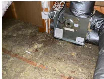
Flexit avtrekk montert på loftet
