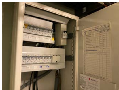
Sikringskap i entreen
