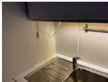
Lys-opplegg i kjøkken.
