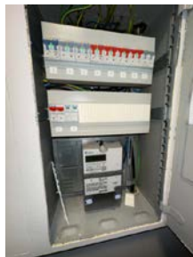
Sikringskap med automatsikringer.
