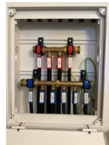
Samleskap med rørkurser og stoppekraner
