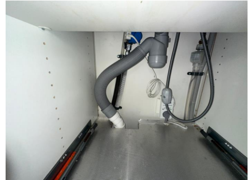
Røropplegg i kjøkkenbenk med Waterguard
