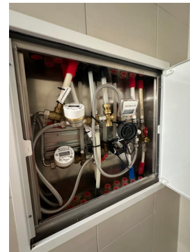
Samleskap med rørkurser og stoppekraner
