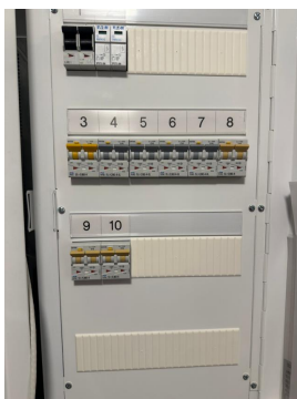
Sikringskap med automatsikringer.
