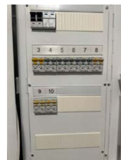
Sikringsskap med automatsikringer.
