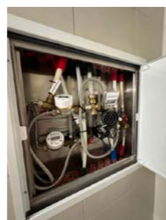
Samleskap med rørkurser og stoppekraner
