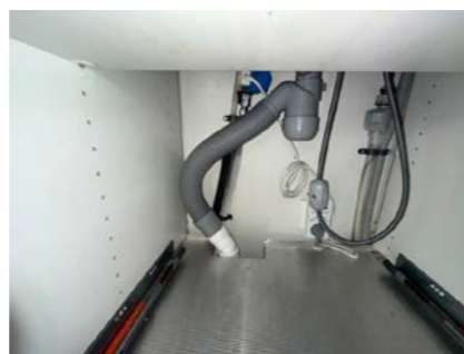
Røropplegg i kjøkkenbenk med Waterguard
