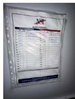
Kursoversikt for rør i samleskap
