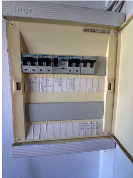
Sikringskap med automatsikringer.
