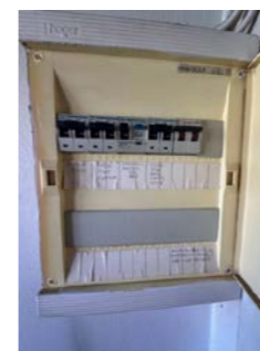
Sikringsskap med automatsikringer.
